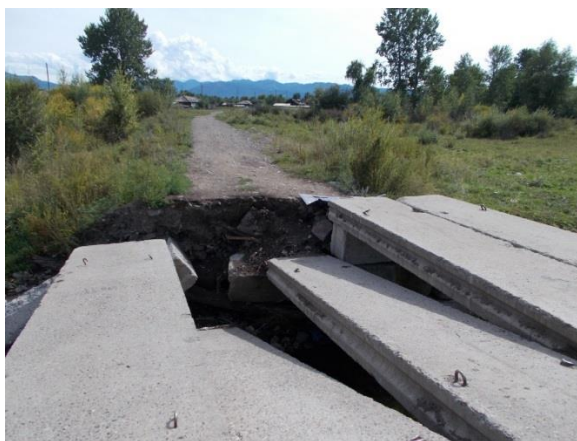
Рис. 3.12. Разрушенный мост через протоку р. Элегест (с. Элегест)
