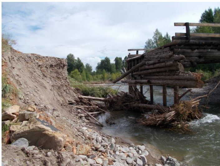
Рис. 3.14. Разрушение моста и участка автодороги подъезд к с. Арыскан в Улуг-Хемском районе из-за активизации гравитационно-эрозионных процессов
