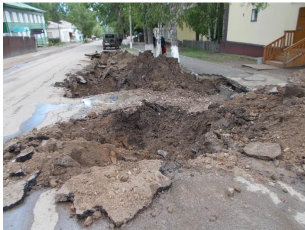
Рис. 3.16. Разрушение дорожного полотна дороги по ул. Гагарина, начаты ремонтные работы, с. Хову-Аксы Чеди-Хольского района
