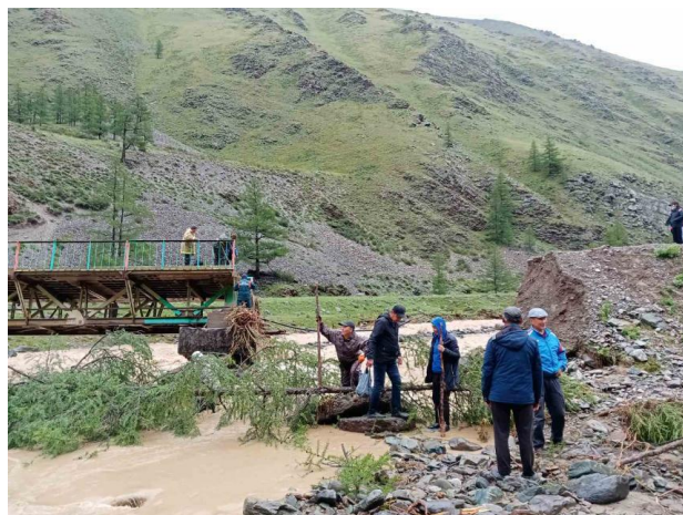
Рис. 3.15. Разрушение полотна дороги и моста через р. Барлык в Монгун-Тайгинском районе
